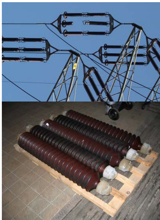
Rys. 8.1. Izolatory LS 75/21 z lat 1970 - 71 na linii 220 kV, widoczny jest izolator zerwany w 2005 roku. Na dole pozostałe izolatory z łańcucha po demontażu.
